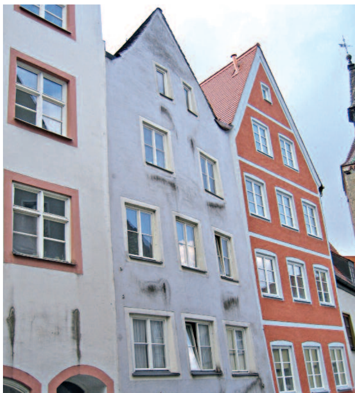
1 Der Befall von Algen und Pilzen sorgt oft für eine unansehnliche Veränderung der Fassade.
